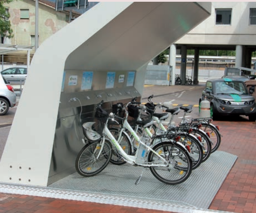
☑ Solar-Ladestation in Bozen (Italien).
